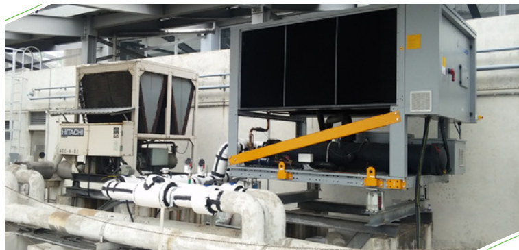
◀ Oil-free chillers 無油磁浮式製冷機
